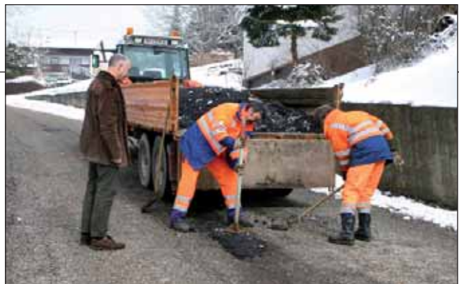
Erste Ausbesserungen der Frostschäden schon Mitte März
